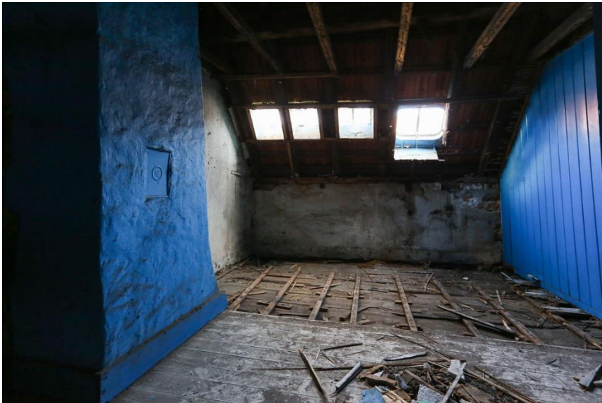
Foto van zolder huisnummer Houtstraat 11. Onder de recente dekvloer de originele eiken kinderbinten met hierop de vloerdelen. Foto: Ton Desar, Gemeente Venlo
